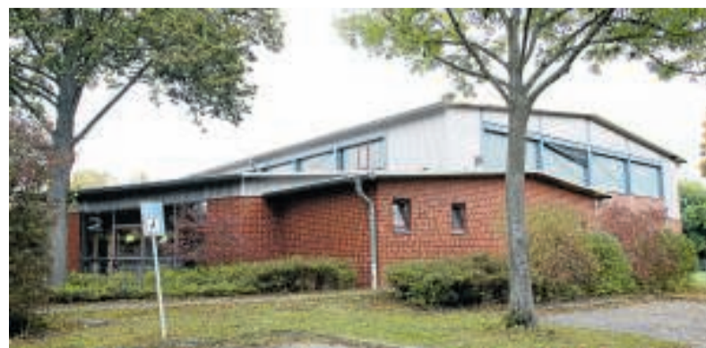
Die Halle der Grundschule Alt-Wolfsburg ist wegen eines Wasserschadens gesperrt.
